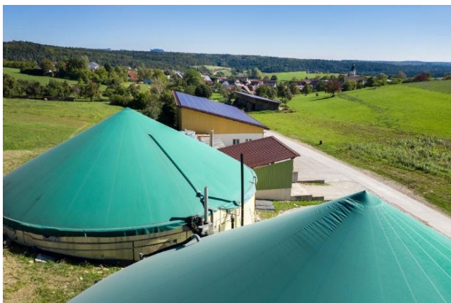
Teile einer Biogasanlage in Mauenheim bei Tuttlingen. Foto: Plattform EE BW / Kuhnle & Knödler
